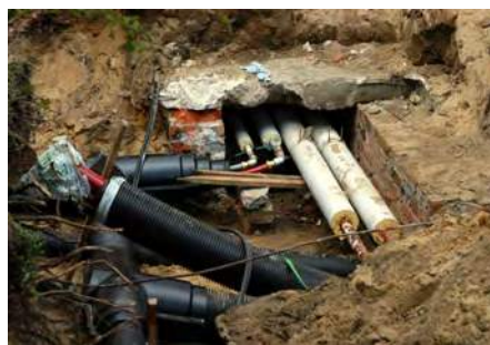
Senoji šildymo sistema (baltos spalvos vamzdžiai) atnaujinta, sumontavus naujus gerai izoliuotus vamzdžius (juodos spalvos).
